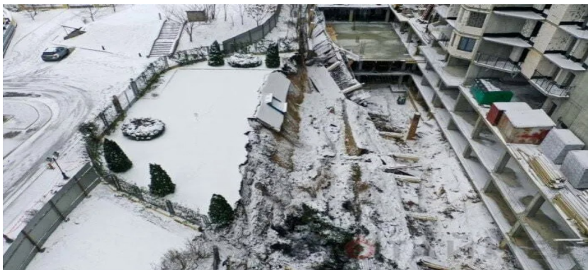
Обвал ґрунту в Одесі 07.02.2021 р.
